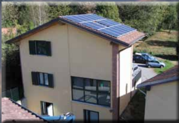
Impianto sul magazzino
